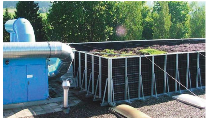
Biofilter-Anlage auf dem Firmendach
