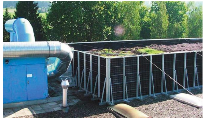
Biofilter-Anlage auf dem Firmendach
