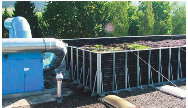
Biofilter-Anlage auf dem Firmendach
